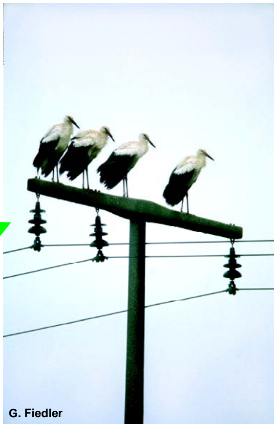
Vogelfreundlicher Mittelspannungsmast mit Hängeisolatoren (links)
